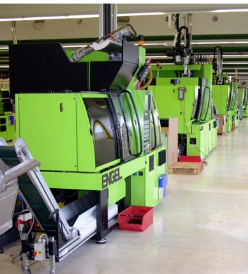
Insgesamt 34 Spritzgießmaschinen von 15 bis 700 Tonnen Schließkraft produzieren jährlich ca. 300 Millionen Kunststoffteile.
